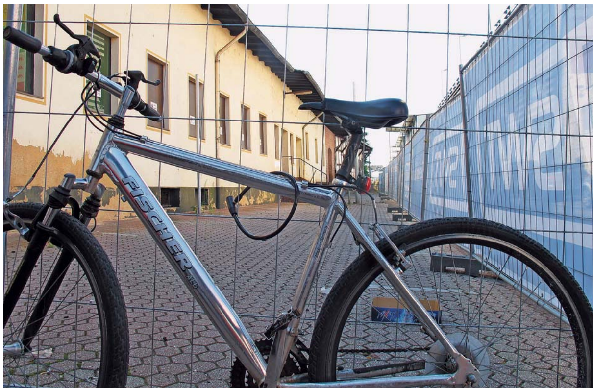
Um den teilweise maroden Schuppen neben dem Hauptbahnhof abzusichern, haben die Stadtwerke das Gelände eingezäunt. Nach dem Abriss soll hier eine Fahrradgarage entstehen. TV-FOTO: CHRISTIANE WOLFF
